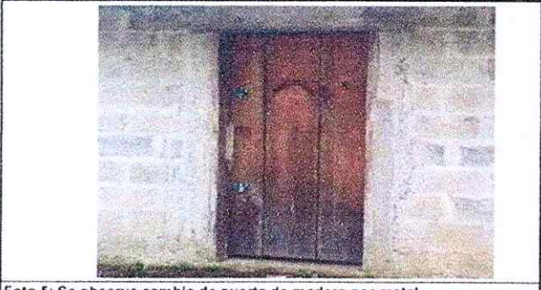
Foto 5: Se observa cambio de puerta de madera por metal.
